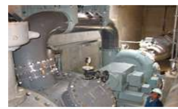
【水力発電設備】
