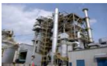
【バイオマス発電設備】
