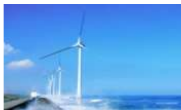
【風力発電設備】
