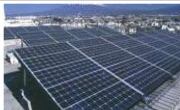
【太陽光発電設備】
